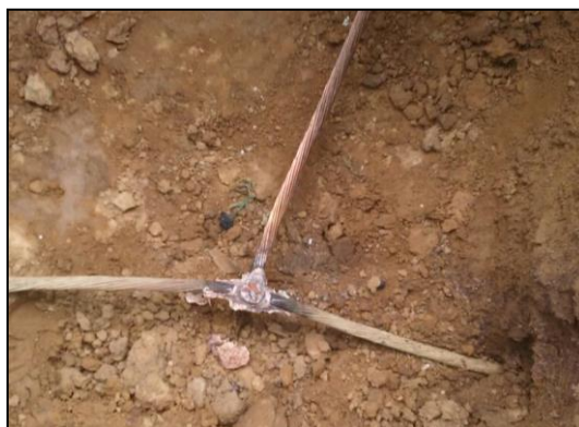
Figura 3 – Conexão exotérmica tipo T Fonte: Foto do próprio autor (2017)
